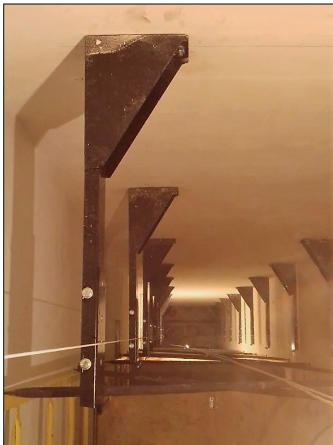
Усиленные кронштейны направляющих в шахте
