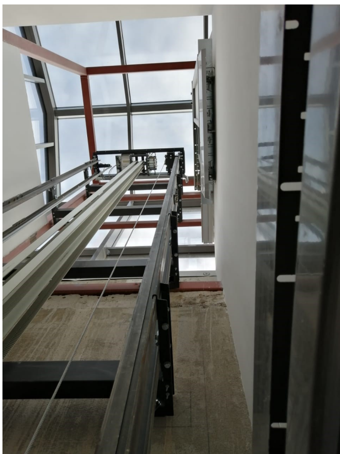
Шахта лифта и направляющие с выходом на крышу
