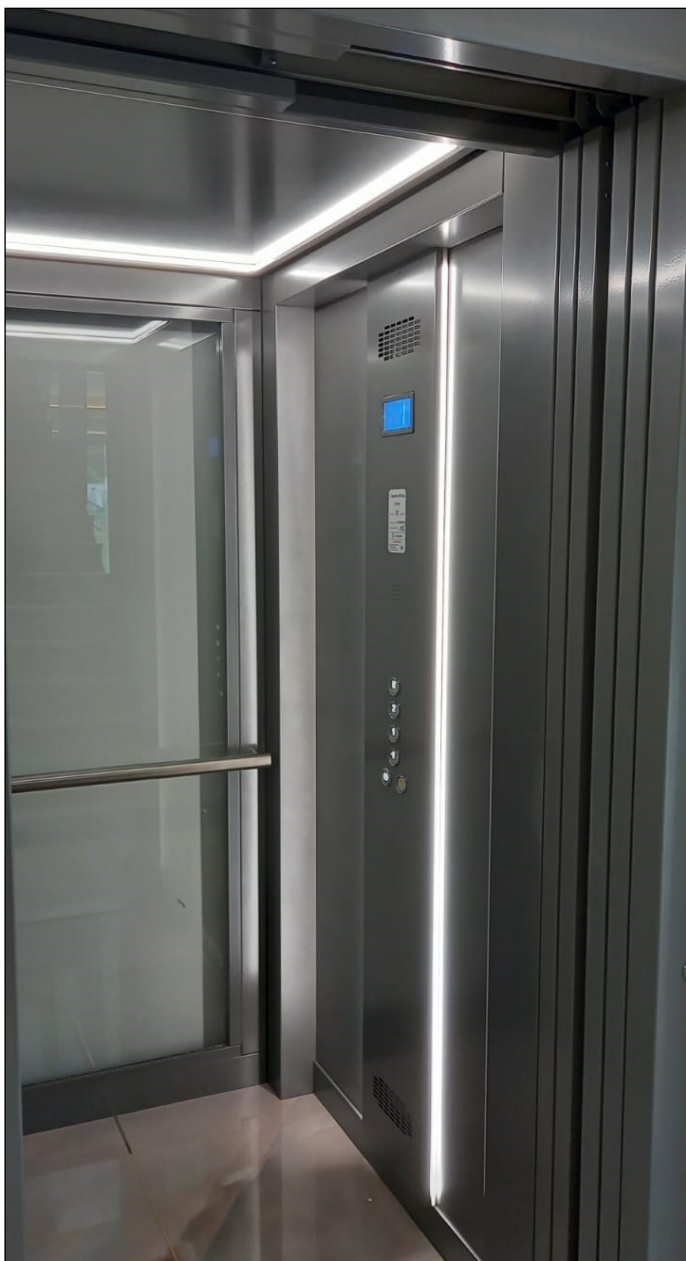
Кабина пассажирского лифта в частном доме
