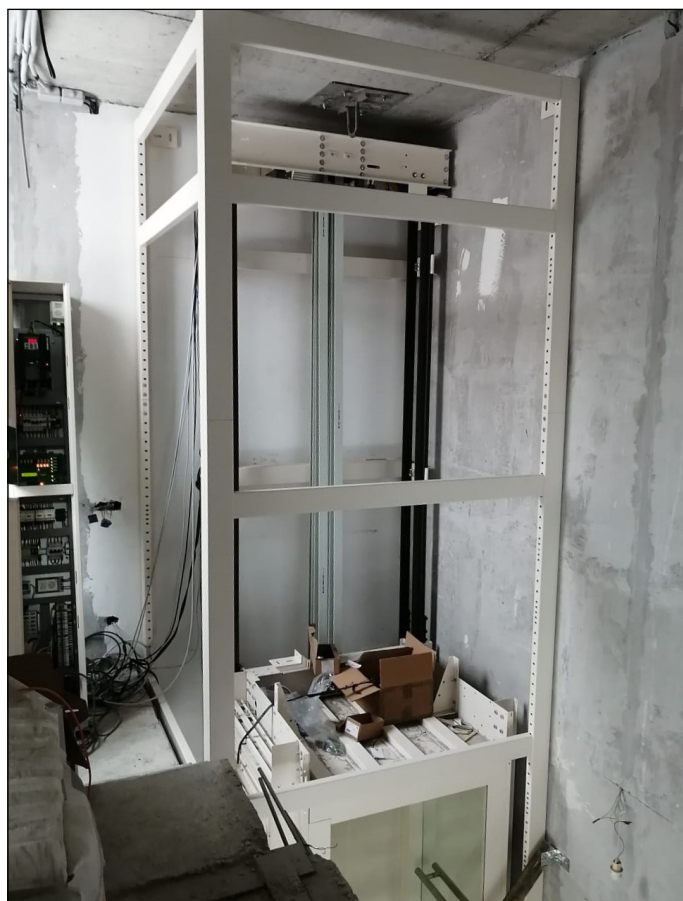
«L»-образная металлокаркасная шахта лифта
