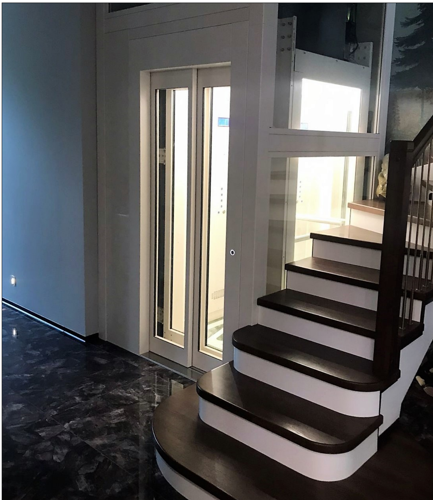
Электрический домашний лифт, установленный к несущей стене, возле лестницы
