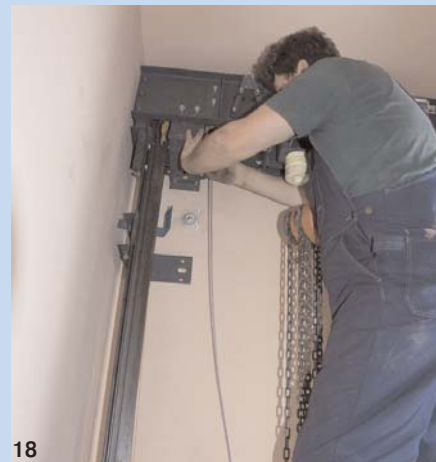
18. Установка ограничителя скорости — одного из элементов обеспечения безопасности пользования лифтом
