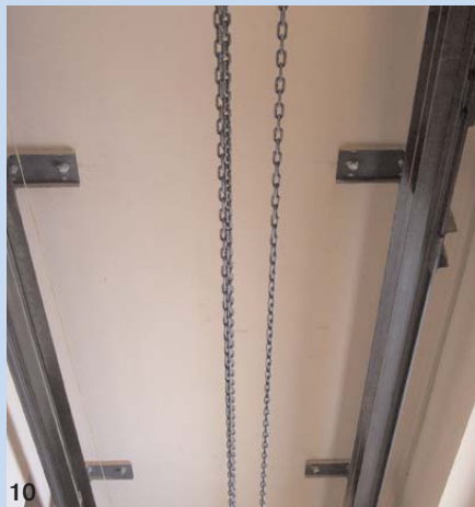
10. Четыре колонны направляющих, по которым, как по рельсам, будет передвигаться кабина лифта
