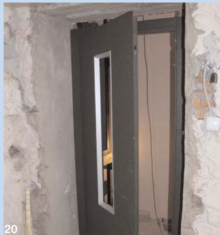
20. Монтаж распашной металлической двери лифта с проёмом под стеклянную вставку в портале цокольного этажа
