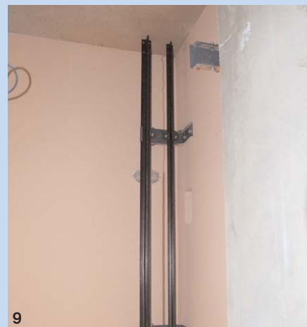
9. Когда установлены кронштейны и направляющие противовеса, монтируют буфер противовеса и сам противовес
